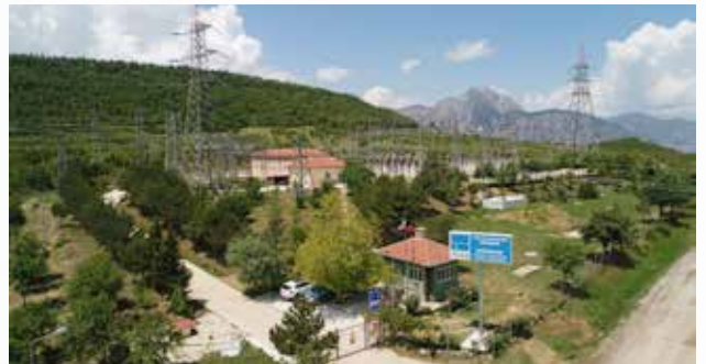
Isparta - Eğirdir Yusuf Özdemir Trafo Merkezi
