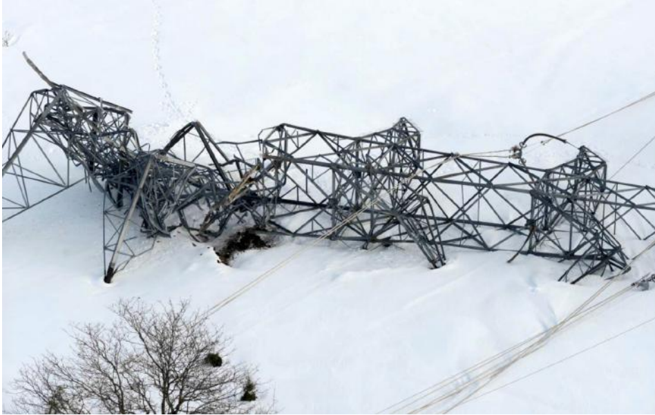
Şekil 6. 400 kV Ada II-Beykoz/ Osmanca-Paşaköy EİH 120 No.lu direk (29 Aralık 2016)
