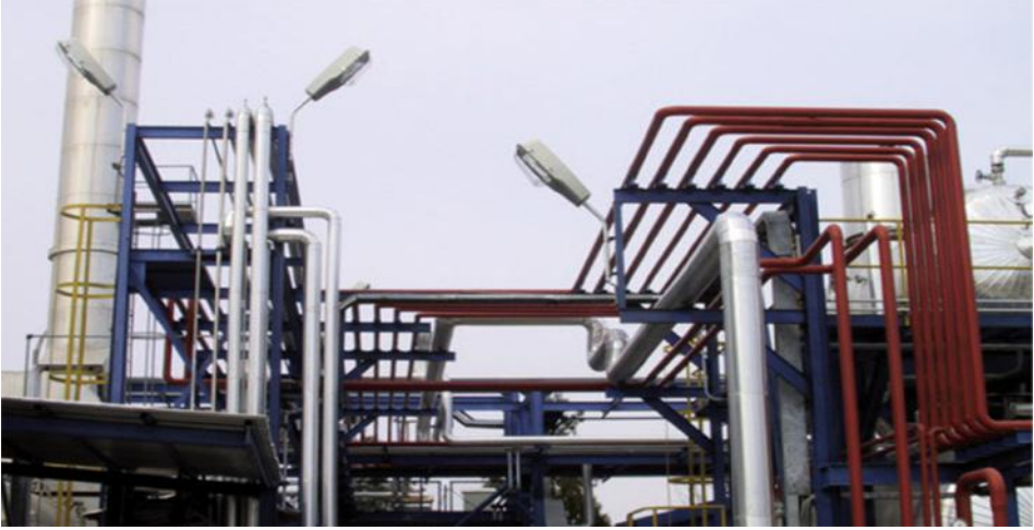
Şekil 5. Yalova Akenerji Akal Kojenerasyon Santrali – Yalova (2 x 5 MW)
