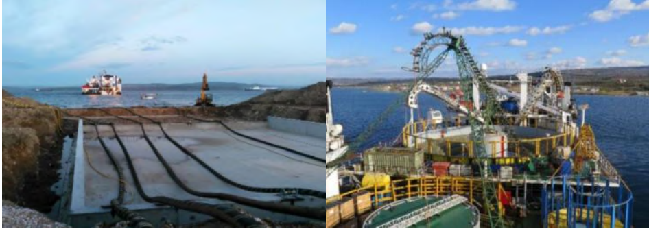
Şekil 19. Lapseki-Sütlüce denizaltı kablo serimi
