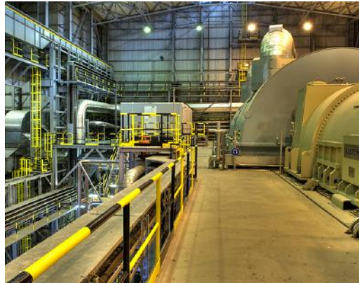
Şekil 8. Ambarlı Doğal Gaz Kombine Çevrim Santrali (Salıcı, s.1)
