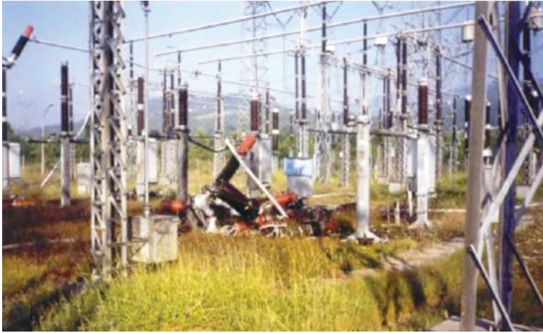
Şekil 5. Osmanca trafo merkezi hasarlı İkitelli fideri (17 Ağustos 1999)
